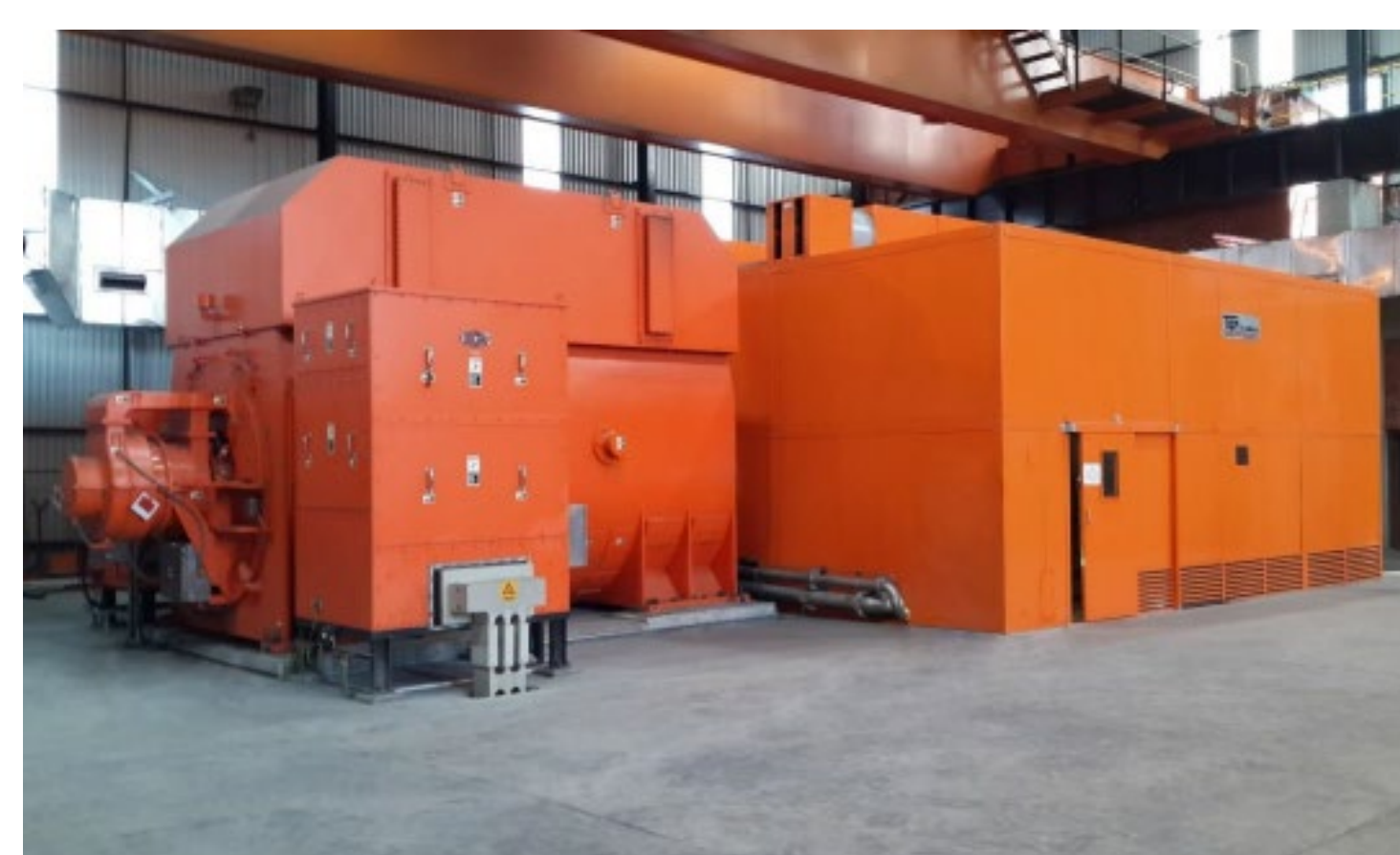
FGD Booster Fan Motor
